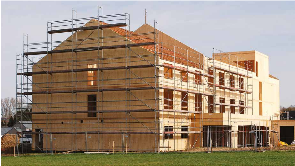
Figure 4 : chantier de la maison de repos à Ramilies © Architecte : Ateliers d'Architectes Alain Jaume – Entreprise : TS Construct
