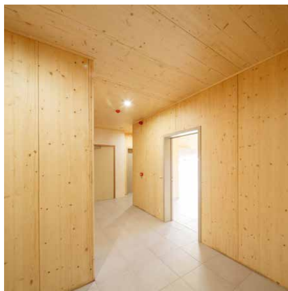
Figure 1 : Chemin d'évacuation en bois massif ignifugé. Résidence Service le Fontiloy, Belgrade. ©Stabilame
