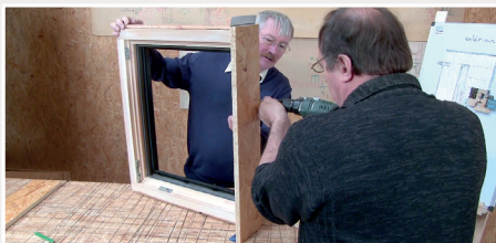
Fixation des montants du précadre (avec adhésifs et joint étanche) sur le bâti de la menuiserie (ouvrant déposé) par des vis de diamètre 6mm minimum – 4 vis sur la longueur
