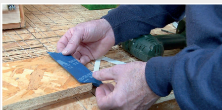
Préparation des adhésifs sur les panneaux OSB constituant les montants du pré-cadre
