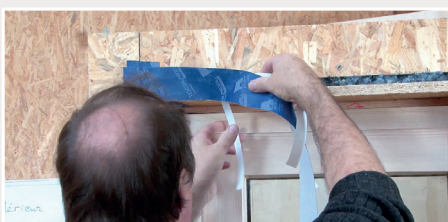
Pose de l'adhésif pour effectuer le raccord d'étanchéité entre le précadre et le retour du panneau contreventant ou du panneau en bois massif
