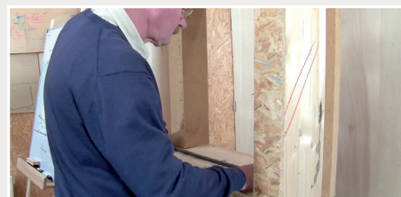
Positionnement du joint de mousse pré-comprimé imprégné de résine synthétique (compribande) en partie basse de la menuiserie et calage
