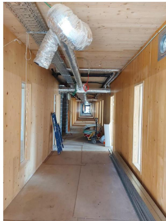
Techniques dans couloir avec faux plafonds
